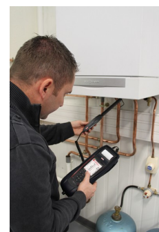
Vérification CO chaudière
